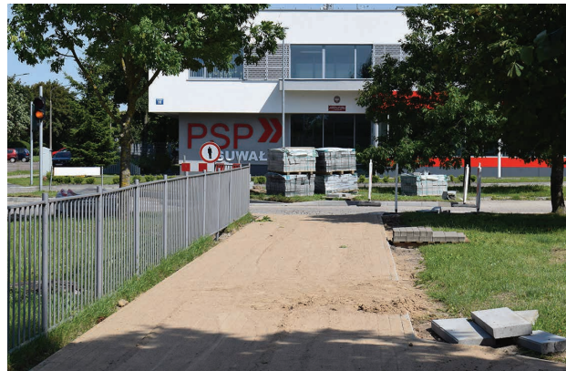
Chodnik przy ul. W. Witosa znajdował się w złym stanie
