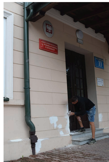
Przed trzema laty wyremontowano SP 9, jak widać konieczne są poprawki
