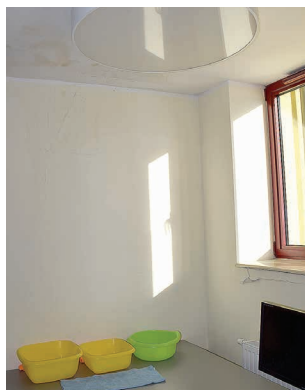
W budynku Midicentrum przy ul. W. Witosa 4A po obfitych opadach deszczu trzeba ustawiać miski na wodę, która leje się z sufitu
