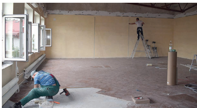
Ostatnie remonty przeprowadzone w bibliotecznym budynku przy ul. E. Plater 33A nieco wydłużyły czas użytkowania tych pomieszczeń, ale wciąż konieczna jest przebudowa dachu
