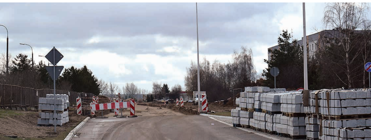
Budowa kolejnego fragmentu tzw. „Trasy Wschodniej” na odcinku od ul. Północnej do ul. Wylotowej trwa już kilka miesięcy
