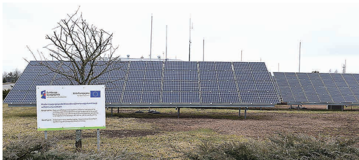
Panele fotowoltaiczne Przedsiębiorstwa Wodociągów i Kanalizacji w Suwałkach zasilały pompy głębinowe ujęcia wody, urządzenie stacji uzdatniania wody oraz pompy sieciowe
