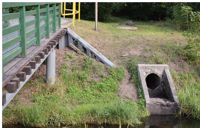
Z tego kanału burzowego wyciekły ścieki do Czarnej Hańczy
