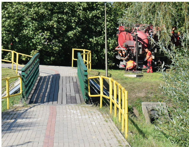
Na miejscu wycieku pracowały wszystkie ekipy służb ratunkowych
